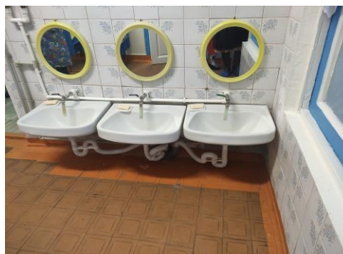
Проверка бюджетных средств, направленных на проведение ремонта системы канализации в здании МКДОУ д/с «Огонек»
