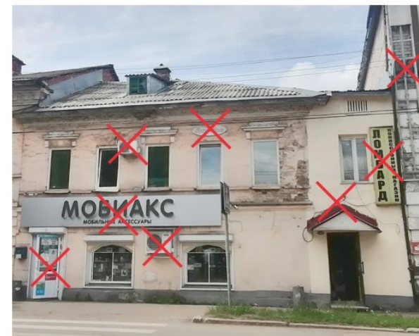
Вывеска перекрывает архитектурные элементы и не соответствует масштабу здания; не аккуратная коммуникация; вертикальная вывеска; табличка в не допустимом месте; обилие объявлений на двери; кондиционер.
