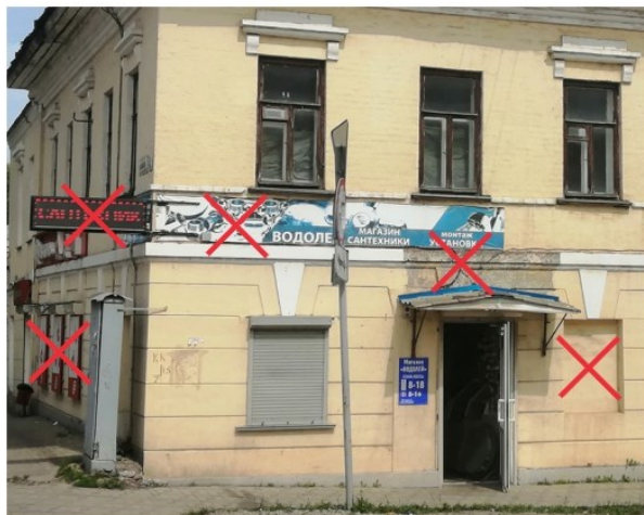
Угловая баннерная вывеска; применение медиаэкрана; не аккуратная коммуникация; окна зашиты баннером; заложенный проём.
