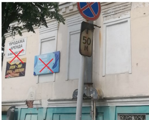
Баннерные растяжки; перекрытие архитектурных элементов здания.
